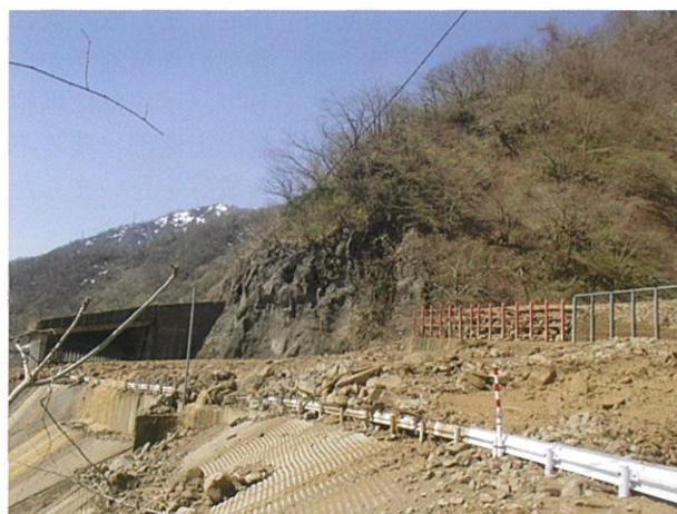
写真 2.1 国道への土砂流出状況
