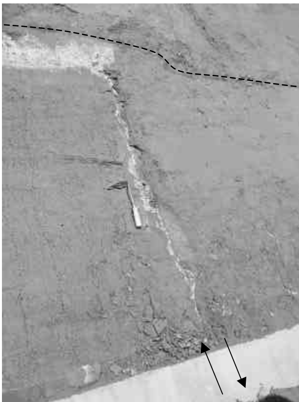
写真 - 3 凝灰岩をドラッグする断層 (図 - 3 中央部右寄り)
