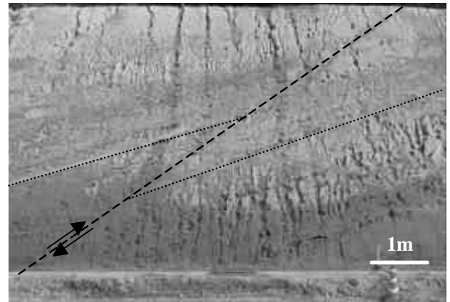
写真 - 5 逆断層露頭(斜面長約 10m)
